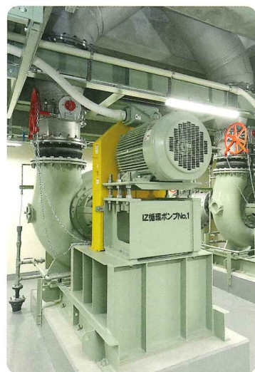
IZ循環ポンプ
