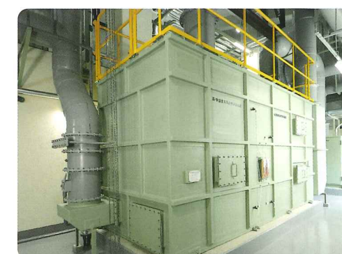
高・中濃度臭気 低濃度臭気 活性炭吸着塔
