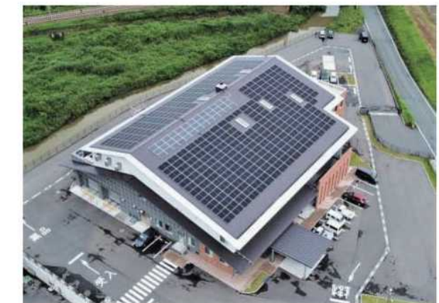
直方市汚泥再生処理センターに設置された太陽光パネル
