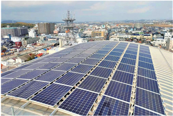
市役所屋上に設置された太陽光パネル
