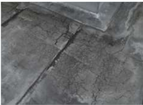
防水層にひびがある
