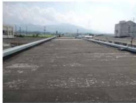
防水層の劣化が25%以上
