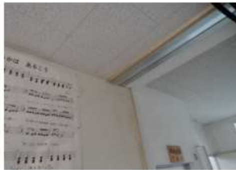
エキスパンションジョイント部分からの雨漏り
