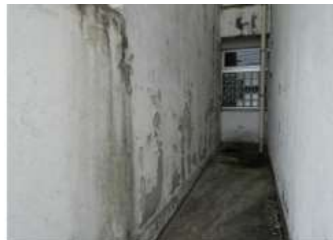
塗装の剥がれ
