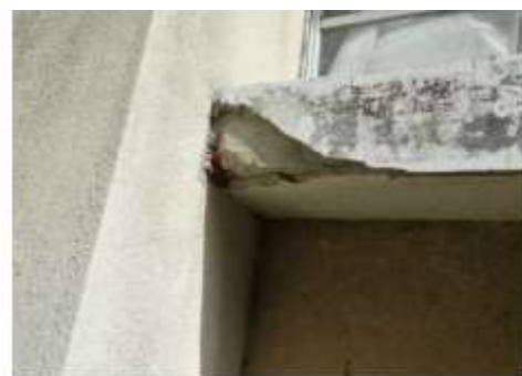
モルタルの剥落
