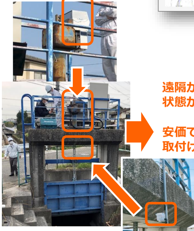
水位を測定するセンシングユニット
